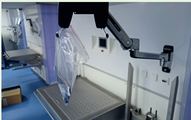
De nye arbejdsstationer i beskyttet miljø, som kan hæves og sænkes.
